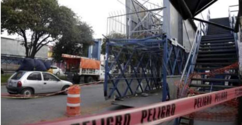
Figura 25 - Puente peatonal desmontado. Puebla México
